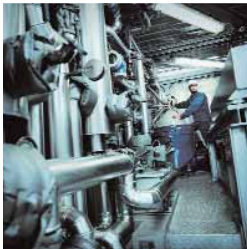
Inside the Blabo separation module
